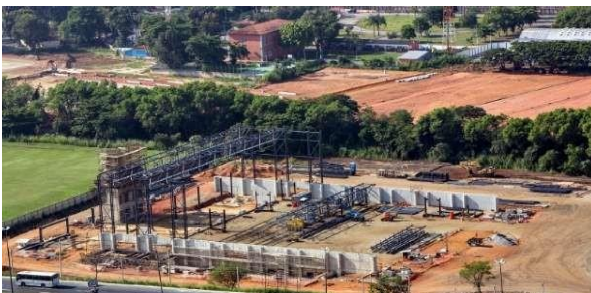
Início das obras da Arena e do Centro de Hóquei, a partir de 2014
